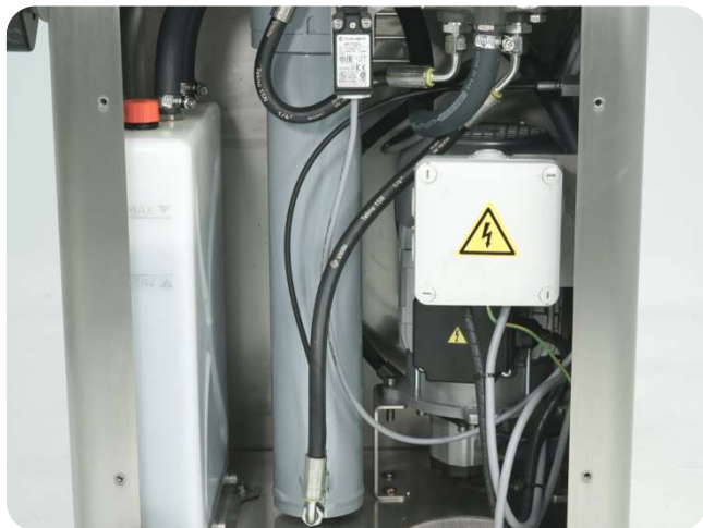
Groupe hydraulique puissant. Réservoir d'huile transparent indépendant.
